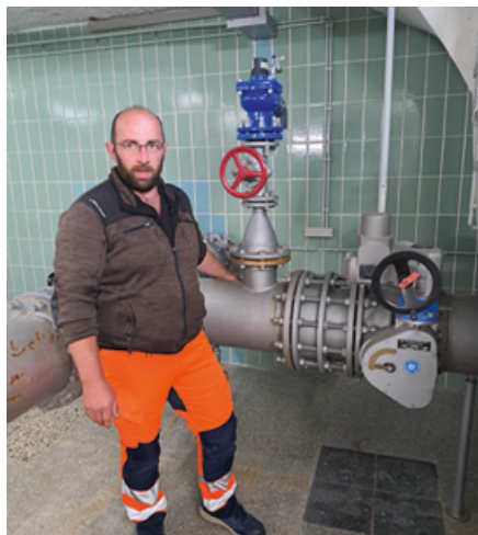
Die Zufuhr läuft automatisiert, kann aber auch manuell eingestellt werden.
