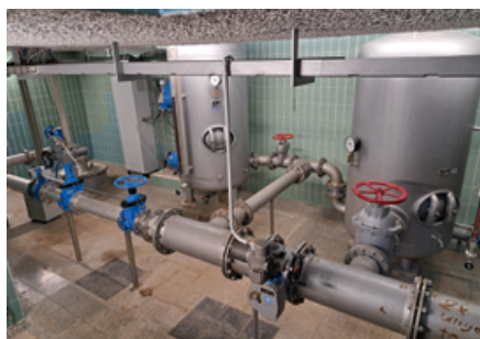
Zwei Pumpen in Festsbach befördern das Grundwasser nach oben.
