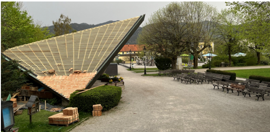
Der Pavillon im Kurgarten erhält für die kommende Sommersaison ein neues Schindeldach.
